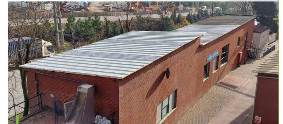
Yenilenen Arıtma Tesis - 2021
